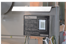
CO2 発生器コントローラ
